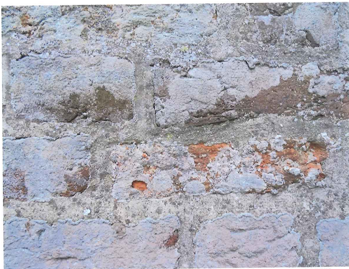
Fot. 23 Fragment zachodniej elewacji zakrystii kościoła, korozja mikrobiologiczna, sierpień 2023 r.
