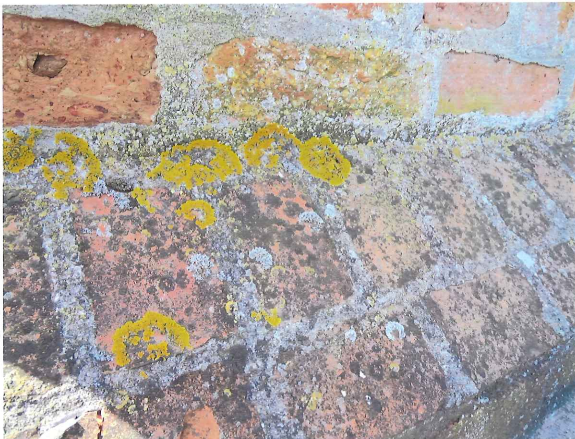
Fot. 25 Fragment wschodniej elewacji kościoła, korozja mikrobiologiczna, sierpień 2023 r.
