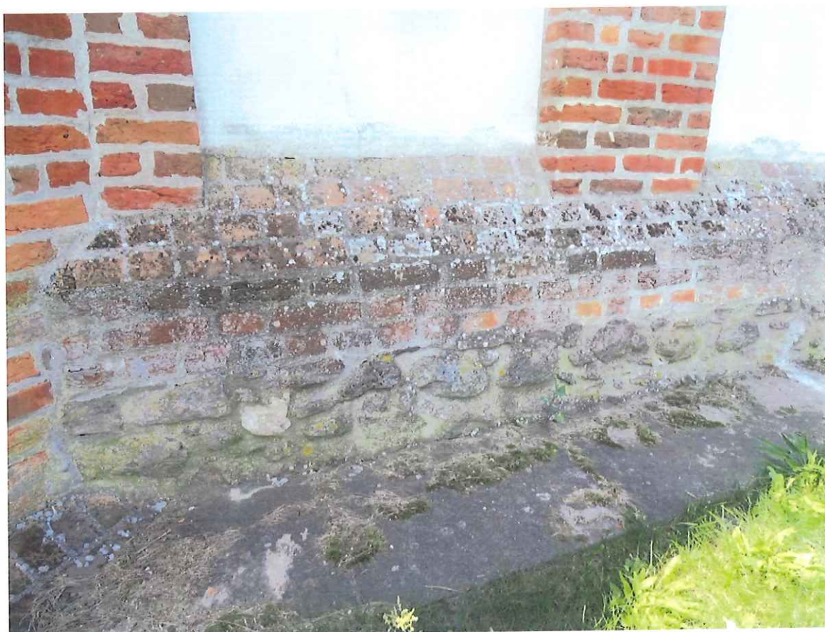
Fot. 24 Fragment elewacji wschodniej kościoła, zniszczenia strefy cokołowej, sierpień 2023 r.
