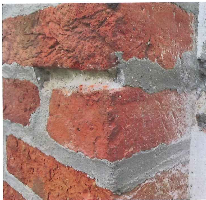
Fot. 2 Fragment wtórnych spoin na ceglanym licu kościoła
