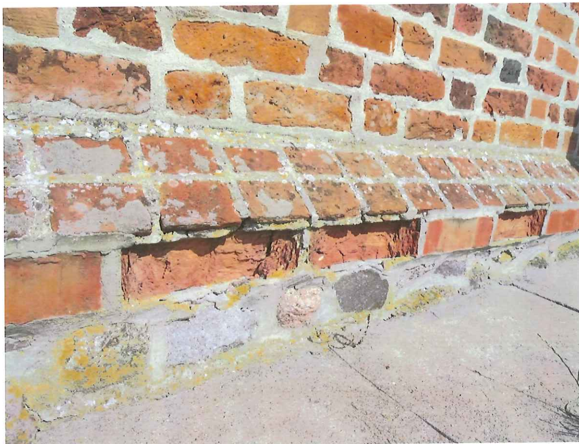
Fot. 21 Elewacja południowa, zniszczenia strefy cokołowej kościoła, sierpień 2023 r.
