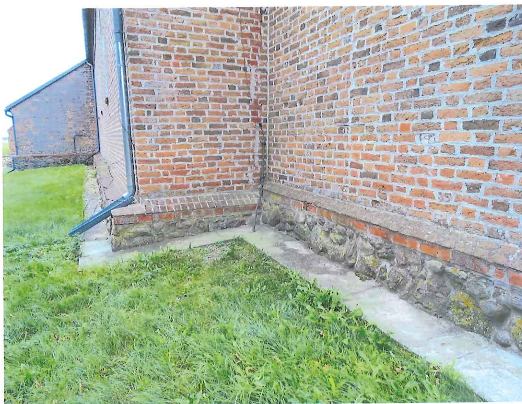
Fot. 20 Strona północna kościoła - fragment elewacji wieży i nawy z betonową wylewką, sierpień 2023 r.
