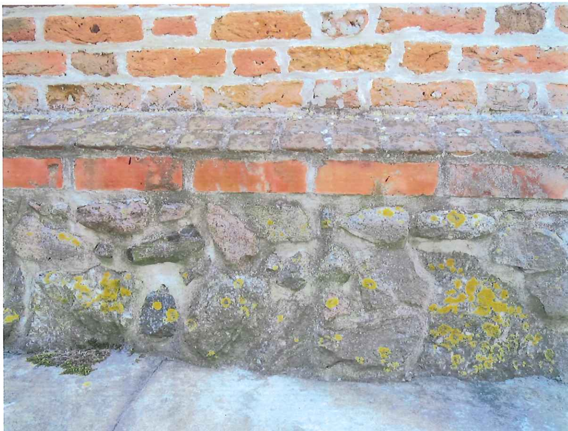
Fot. 26 Fragment elewacji północnej kościoła, zniszczenia strefy cokolowej, sierpień 2023 r.
