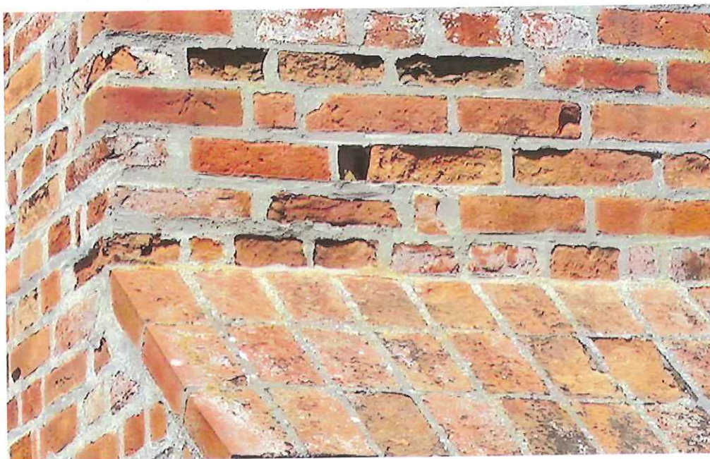
Fot. 4 Głębokie zniszczenia cegieł i zachowane wokół nich wtórne spoiny.
