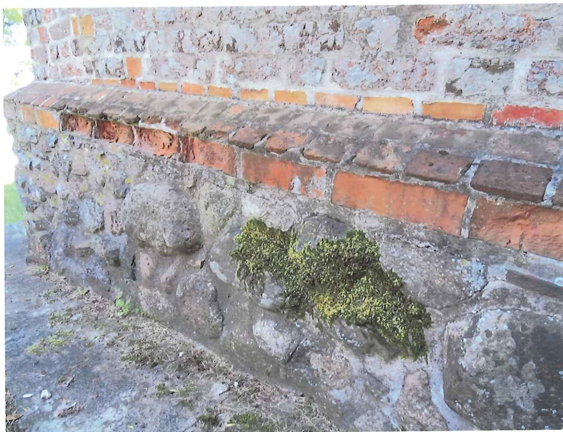
Fot. 22 Elewacja północna, zniszczenia strefy cokołowej kościoła, sierpień 2023 r.
