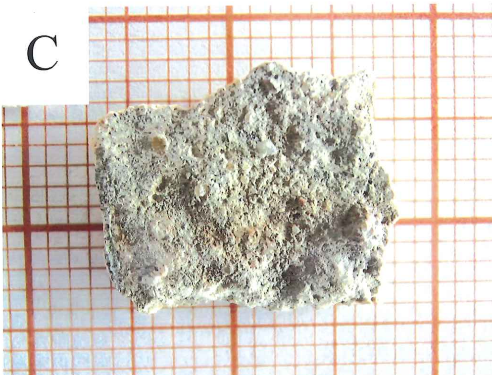
Fot. 3. Próbką C – tynk z fryzu pokryty zacierką/szlichtą, miejsce pobrania fryz na elewacji wschodniej korpusu nawowego.
