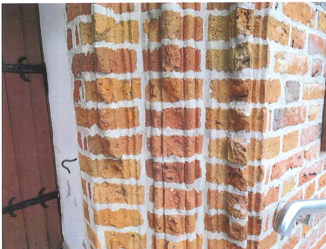
Fot. 11 Ubytki kształtek portalu głównego kościoła p.w. św. Jakuba Apostoła w Żmijewie, sierpień 2023 r.
