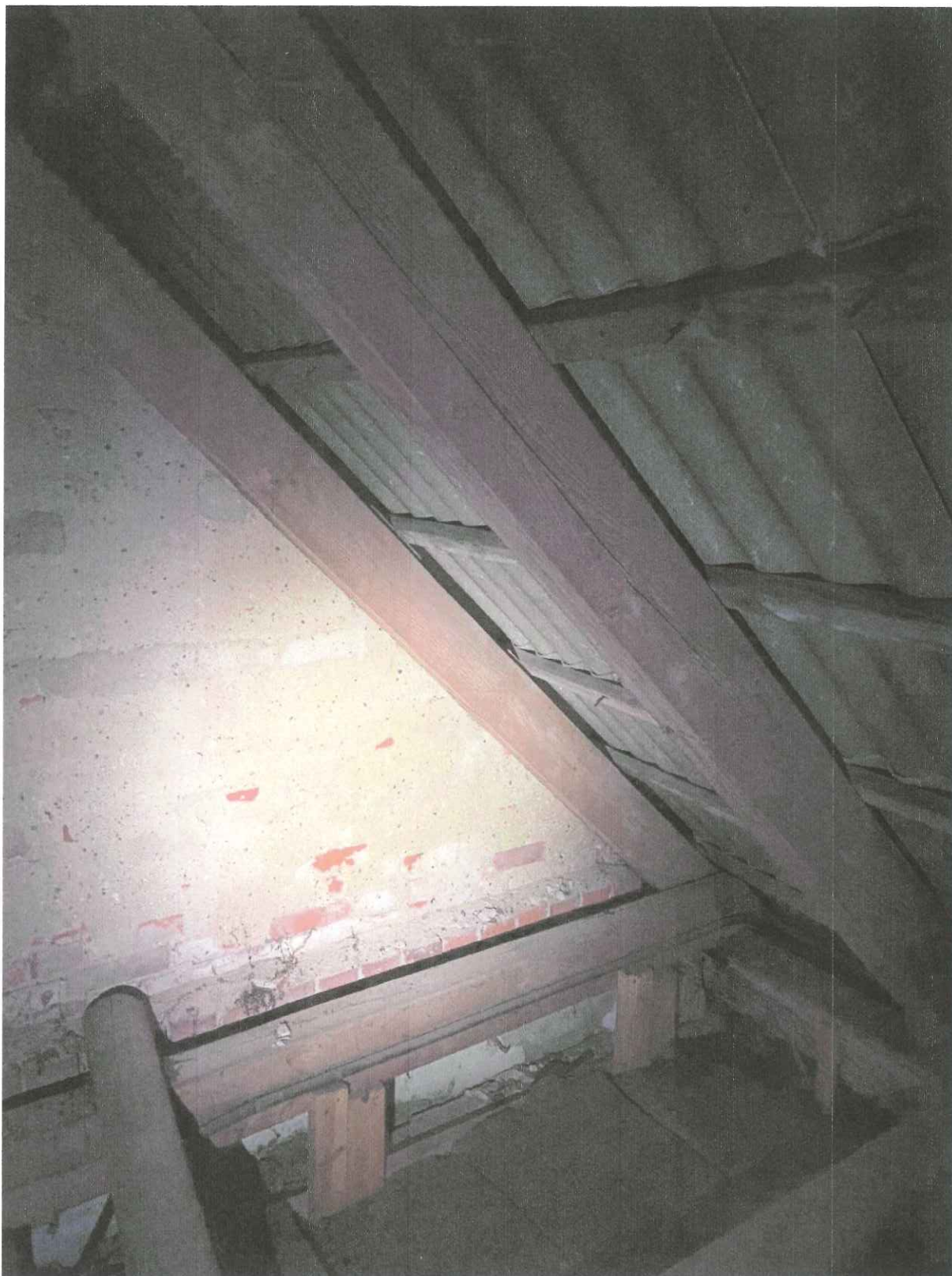
Fot.3. Wizja lokalna – marzec 2024 – Konstrukcja dachu przy ścianie szczytowej kościoła. Stan dobry, Drewno konstrukcji dachu nie ma kontaktu ze ścianą.
